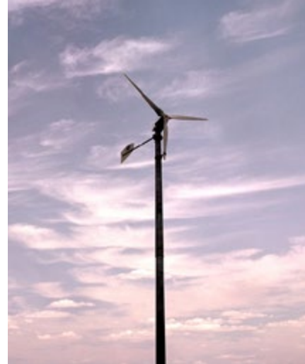
Schleuderbetonmast mit Horizontalläufer
