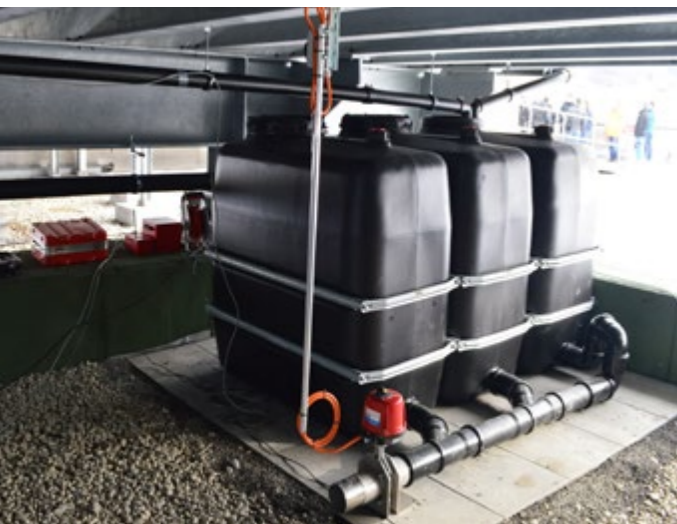
Wassertanks unterhalb der Plattform
